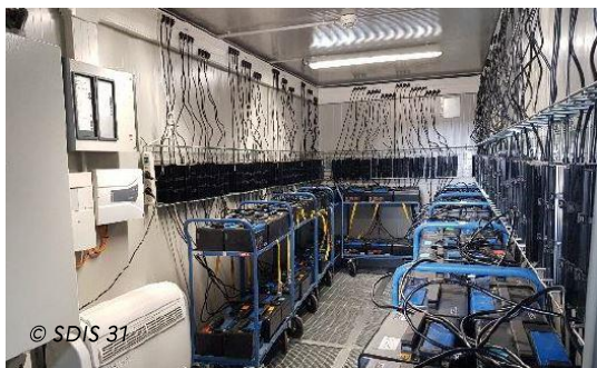
ARIA 54538 – Mise en charge des batteries Li-ion avant sinistre
